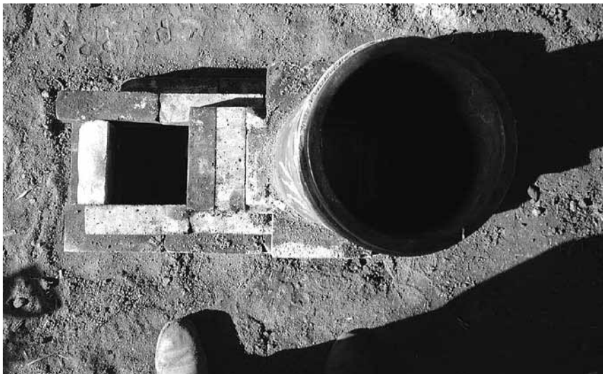
Vedere de sus a butoaielor pentru tubul de alimentare și conducta ascendentă de căldură.
