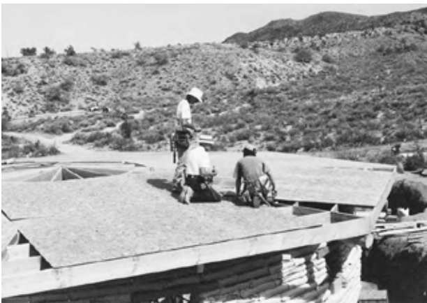
9.19: Penny a utilizat un cadru din cherestea instalat deasupra grinzilor, acoperit cu placaj deasupra și izolat dedesubt.
