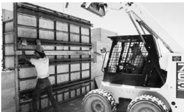
1.5: Cutia cu matrițe poate fi asamblată cu mini-excavatorul. Rafturile de oțel mențin matrițele întocmai și opun rezistență presiunii de tasare.
