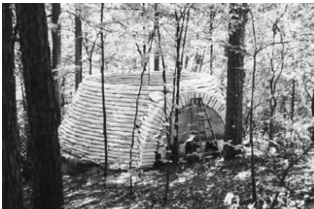
1.2: Cupola din saci de pământ în construcție a Marlenei Wulf, în sânul pădurilor din Georgia.
