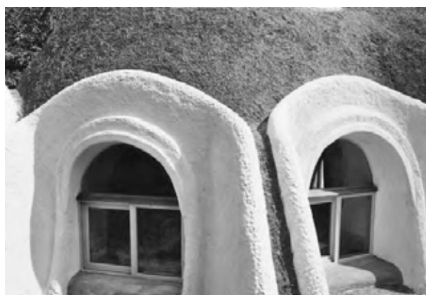
13.3: Fețele verticale ale Honey House sunt protejate cu tencuială de var, în timp ce pervazurile sunt făcute din pământ stabilizat cu var. Ambele au rezistat foarte bine timp de cinci ani.
