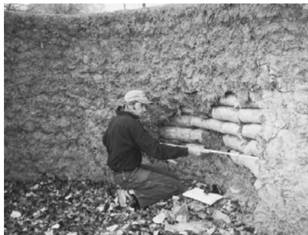
2.11a: Proprietarii acestui zid despărțitor în apropierea unei intersecții aglomerate din oraș au descoperit că o secțiune a tencuiei a căzuse. Motivul este prezentat în poza următoare.
