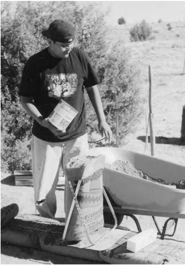
3.11: Umplerea unui sac aflat pe un stativ de metal.
