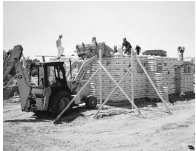
3.35: O echipă formată din 5-7 persoane a construit în 8 zile pereții de 2,86 m pentru Bureau of Land Management Ranger Station (Canton al biroului de administrarea a terenului), de 69 metri pătrați.
