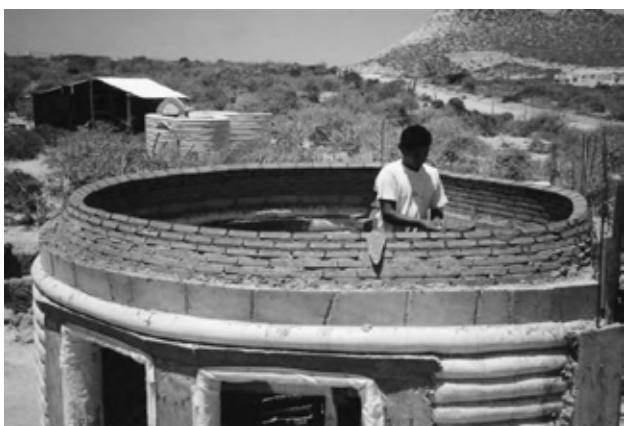
11.7 (sus): Grinzile de legătură din beton acționează ca un inel continuu care împiedică pereții cupolei să fie împinși în exterior.
